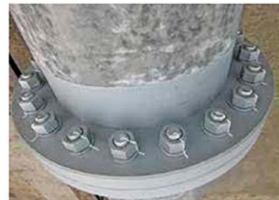
一次締め完了 (トルク値100N・m) 接続ボルトマーキング状況
